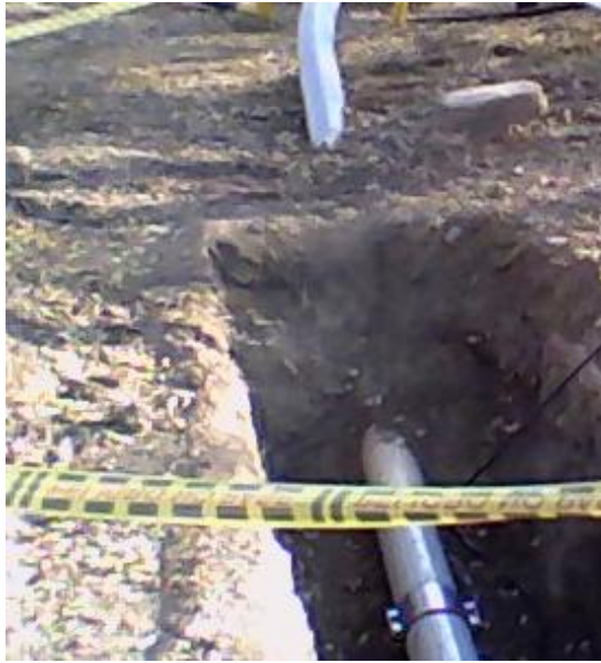
Figura 8 Ejemplo de instalación spotOn® U en una instalación E&P. El sensor fue enterrado y la unidad de comunicación ubicada por encima del suelo
